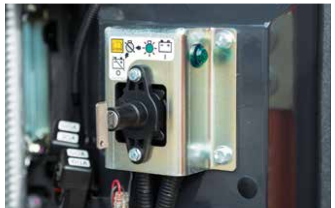
O interruptor para desligar a bateria permite fazer a manutenção em segurança.
